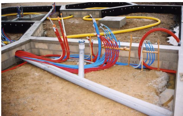
Gros plan sur les réseaux (eau, électricité, télécom et évacuation)
