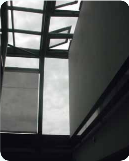
Sorties d'air en partie haute.
